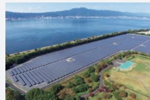
太陽光発電システム (滋賀・矢橋船島メガソーラー発電所)
