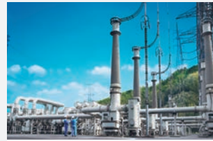
550kV ガス絶縁開閉装置
