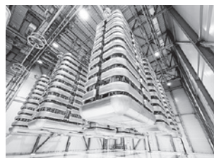
HVDC light® バルブホール
