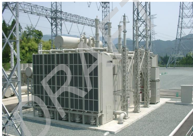
図8—変電所構内における大容量変圧器の例 (1000 MVA, 500/220/63 kV 三相送油風冷式変圧器)
