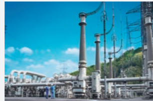
550kV ガス絶縁開閉装置
